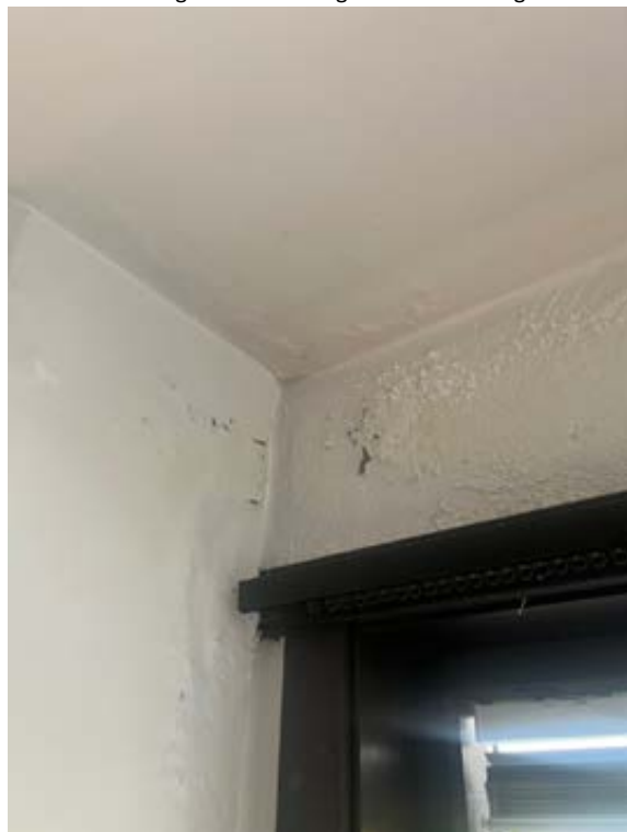
Maling som flasser og stedvis saltutslag
