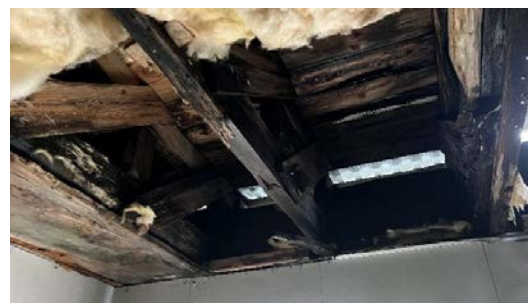
Fuktig treverk med råteskader
