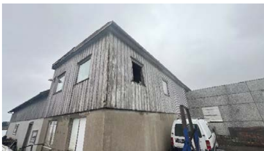
Vinduer med knust glass og råteskader.
