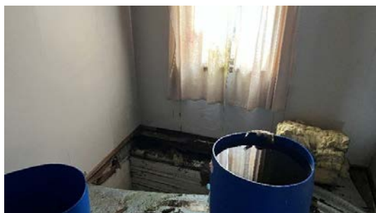
Ødelagt gulv og gulvbelegg på grunn av taklekkasje
