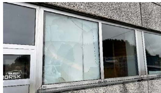
Vinduer med knuste glass.
