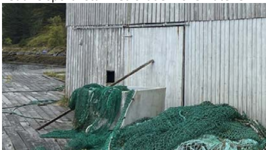
Eldre treport med råteskader og rustne beslag
