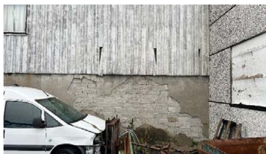
Dårlig tilstand på fasadepuss
