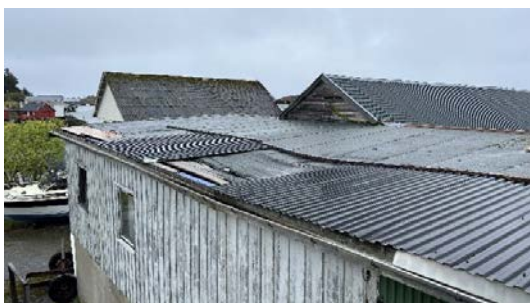
Deler av taket har kollapset
