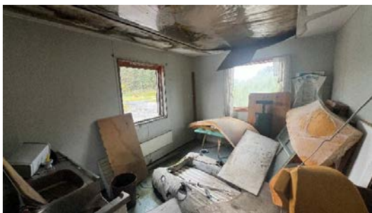
Ødelagte vegger på grunn av lekkasje i taket
