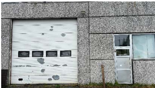
Leddheisport i stål med skader i overflatene
