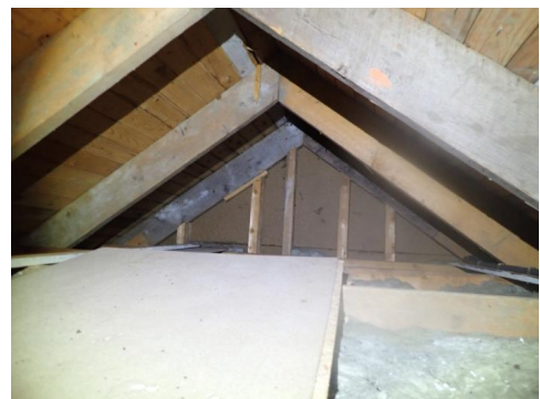
Ingen ventil i røstvegg
