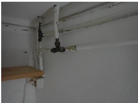
Vannrør i bod under bad
