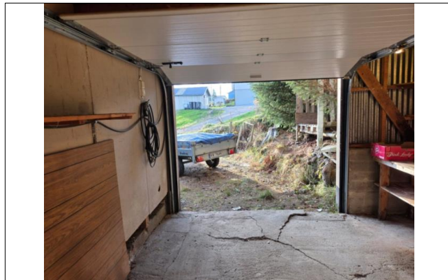
Stor sprekke i betonggulv.
