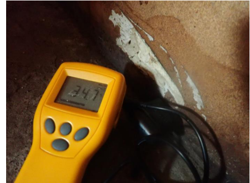
34,7% fuktighet i nedre del av veggplatene
