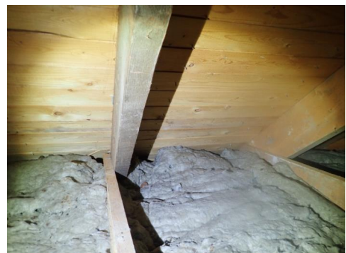
Ingen lufte-spalte av skråtak
