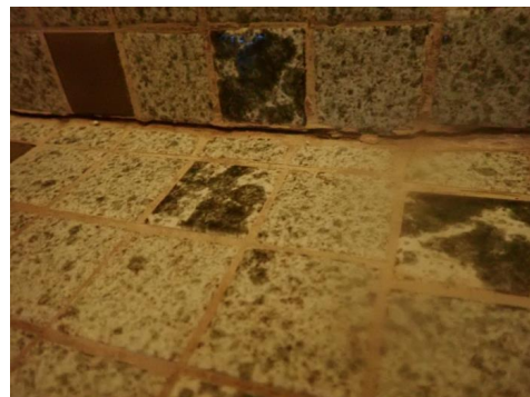
Sprekk mellom gulv og flisfot
