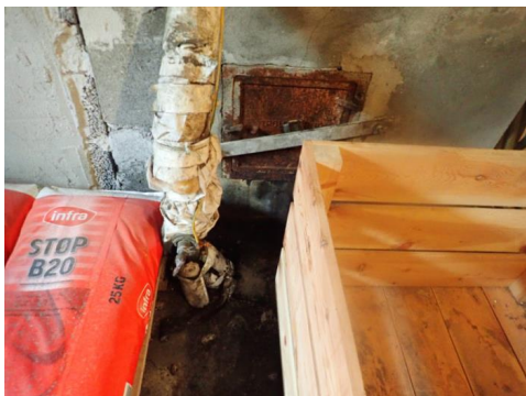
Stoppekran fra byggeår.
