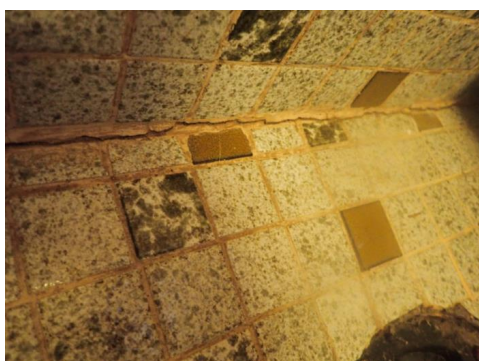
Sprekk mellom gulv og flisfot
