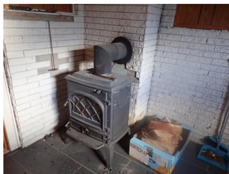
Ovn for fast brensel montert i kjellerrom.
