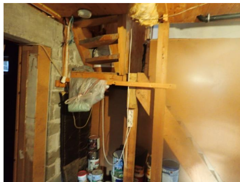
Bratt kjellertrapp uten rekkverk og håndlist
