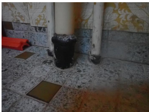
Ingen synlig membran ved rørgjennomføring i gulv.
