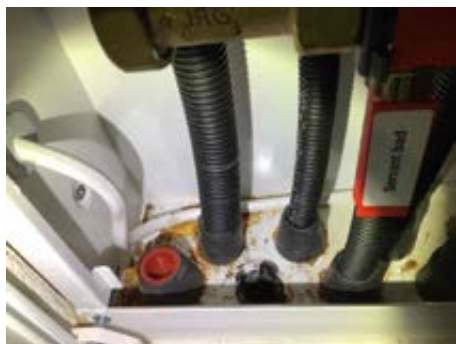
Rust i skapbunn.
