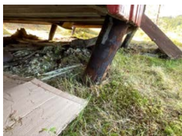
Synlige skjevheter på pilarene
