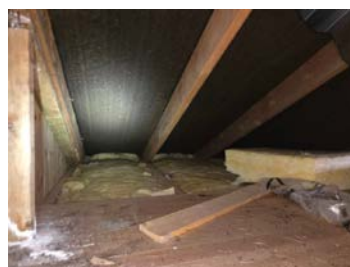
Isolasjon er ført ut til eldre undertak, noe som reduserer luftingen til takkonstruksjonen
