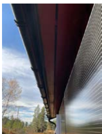
Synlige luftespalter i overgang tak/vegg
