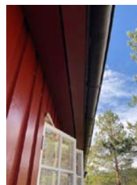
Synlige luftespalter i overgang tak/vegg
