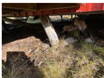
Synlige skjevheter på pilarene
