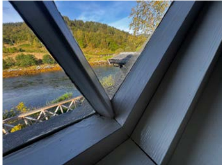
Kondensvann på innsiden av glasset.
