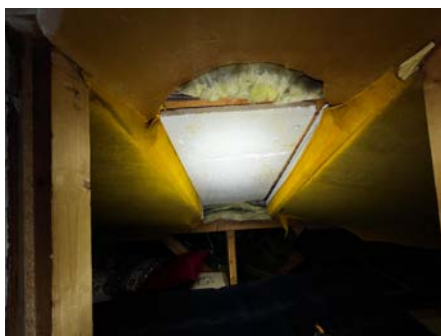
Isopor plater bør fjernes, avgir svært farlig gass ved brann.
