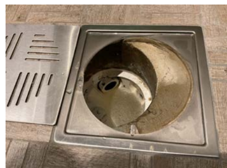
Sluk, tykk påstøp over sluken.
