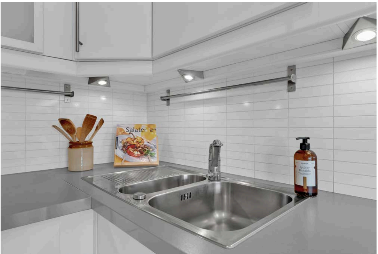
Det er montert komfyrvakt og vannstoppesystem.
