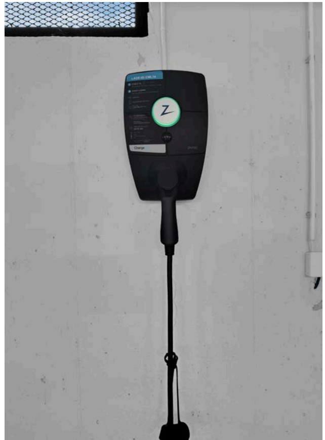
Det er montert ladeboks for elbil tilknyttet garasjeplassen.
