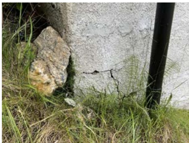
Sprekker i grunnmuren
