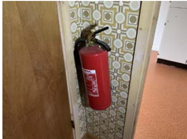
Brannslukker er påvist.
