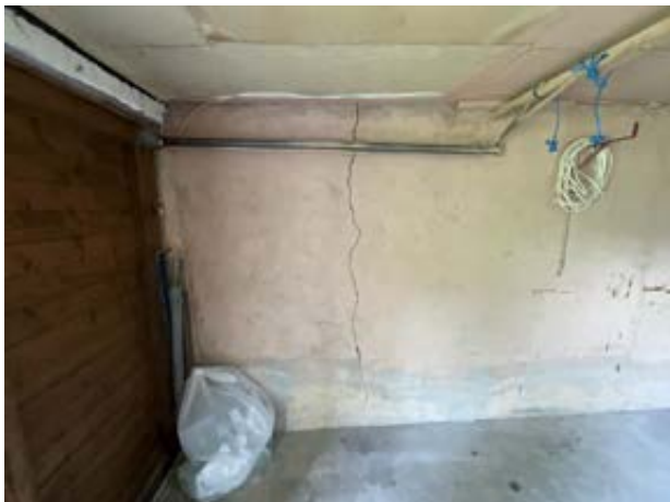
Sprekk i muren.
