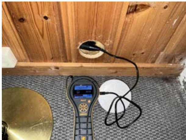
Det er utført fuktmåling i vegg ved kjellerstuen.
