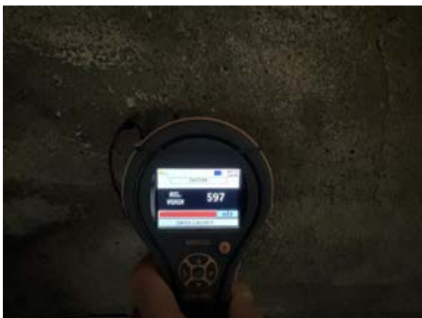
Det er utført fuktmåling i vegg på vaskerommet.
