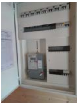
El skap og anlegg er montert av godkjent bedrift
