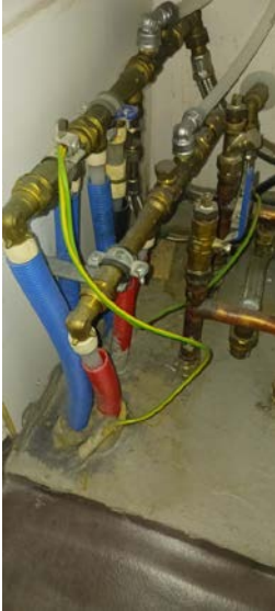
Bilde 1 Ledninger er festet og påmontert enedehylser etter at bilde er tatt.
