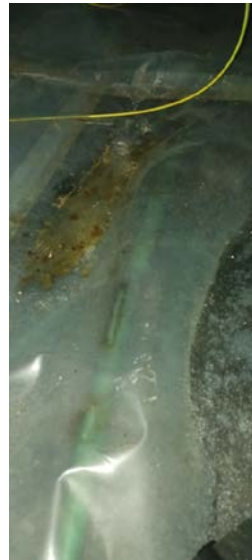
Bilde 2 Tilførselskabel er ikke festet.
