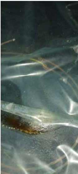
Bilde 1 Jordleder fra jordelektrode til sikringskap ligger løst.
