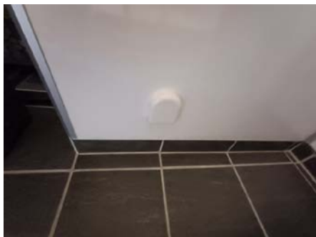
Bilde av lekkasjesikring
