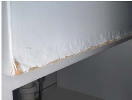
Skade på servantskap.
