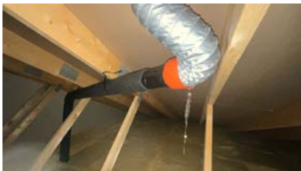
Istapp fra lufterør.
