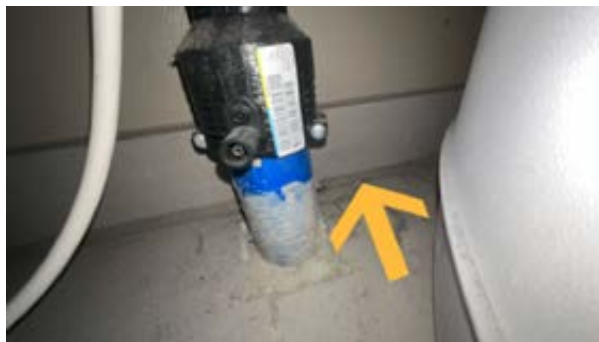
Sprekk i silikonfuge.
