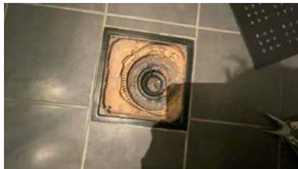
Sluk i dusjsone.
