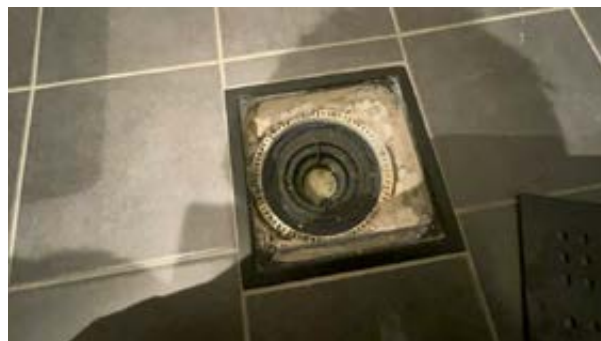
Sluk ved baderomsinnredning.
