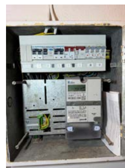
Elsskap, plassert i felles trappegang.
