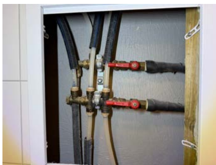
Rørsjakt i baderomsvegg med 2 x stoppekraner
