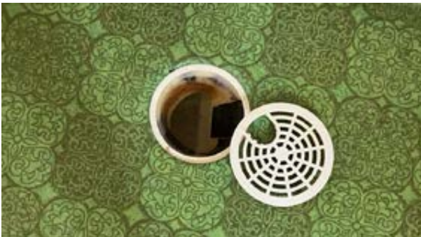
Sluk på bad
