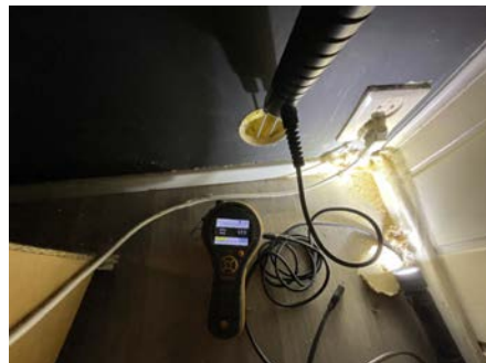
Hulltaking og fuktmåling i bunnsvill i soverommet i kjeller mot sør. 17,5 vektprosent.
