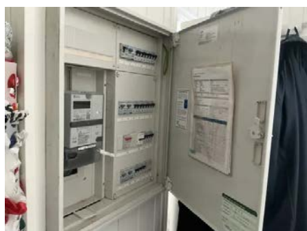
Sikringskap står i bi-inngang/vaskerom.
