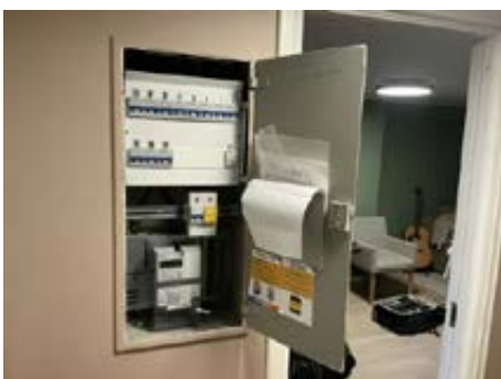
Sikringsskap står i bi-inngang i kjeller.
