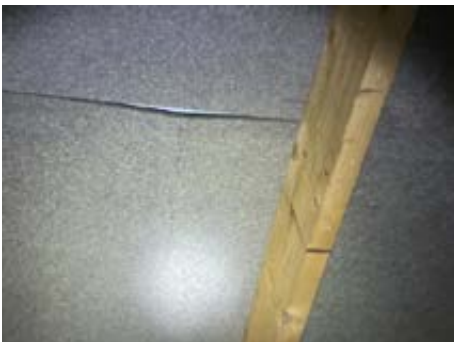
Mindre nedbøyd/glipe i vindtett plate.
