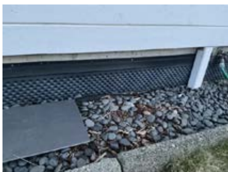
Grunnmurs-plast er synlig over bakke på del av grunnmur. Topp-list er montert.
