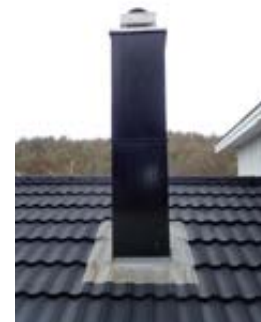
Heldekkende pipebeslag. Ikke stigetrinn og plattform
