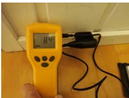
Ingen fuktregistrering i vegg mot bad.
