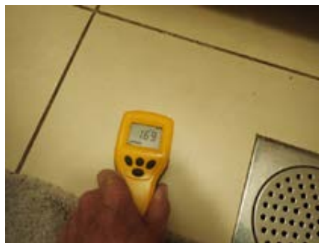
Ingen fuktindikering i gulv.
