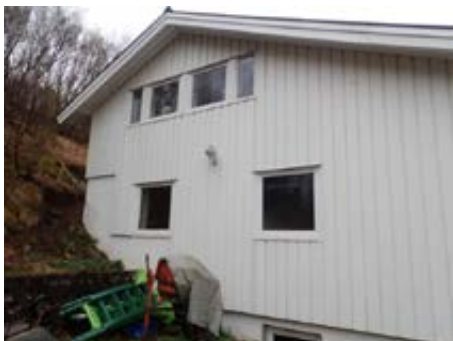
Terrenget heler inn mot grunnmuren
