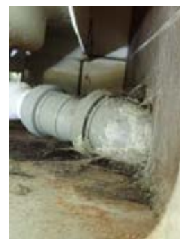
Avløpsvann fra dusjkabinett via rør i vegg
