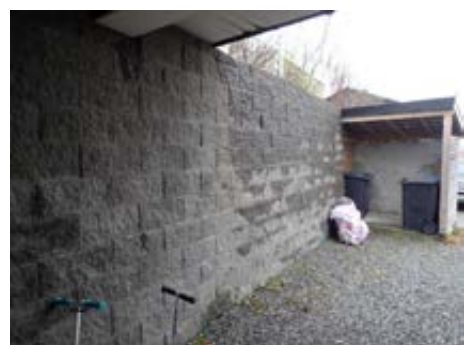
Støttemur mangler rekkverk
