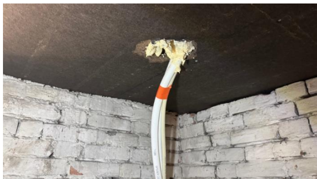
Vannledninger er løse fra hovedinntak til tak.
