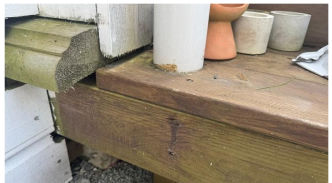
Nedløpet er ikke koblet til drensør (slipper vannet på bakken)
