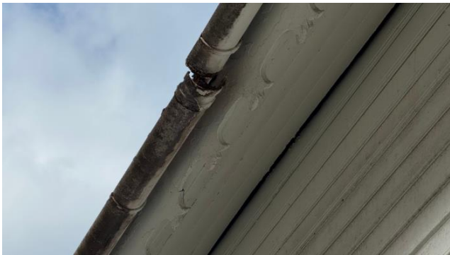
Renneskjøt er løsnet.
