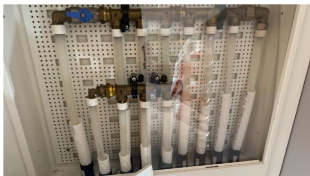
Sprutdeksel og nummererte rør i rør i rørskap. Drensutkast til baderomsgulv.
