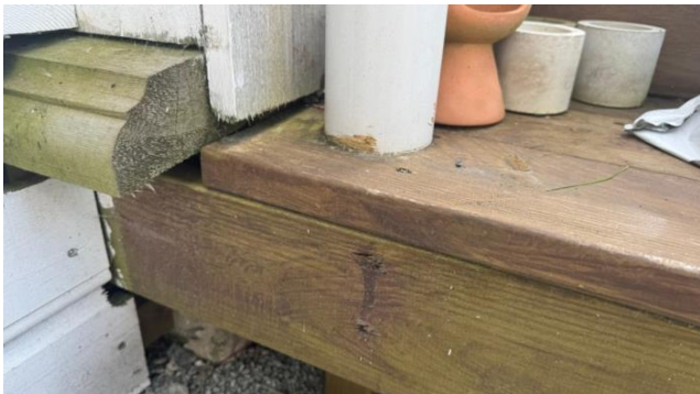
Takvannsnedløp er ikke tilkoblet drens under terreng.
