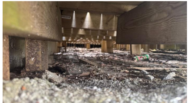
Fall eller slak helling mot grunnmur under terrasse.
