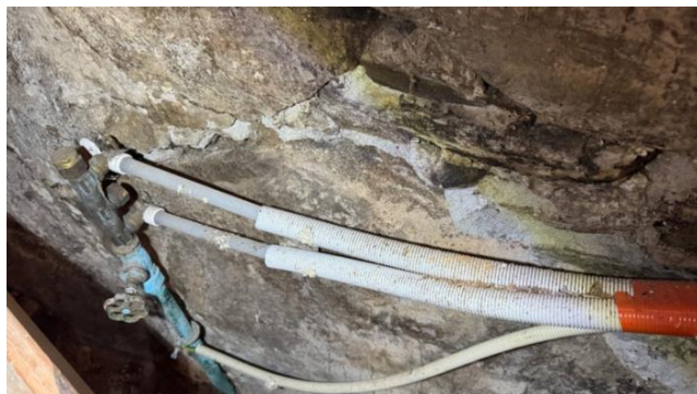
Vannledninger av kobber i inntaket koblet mot nye, trolig en føring for hver seksjon.
