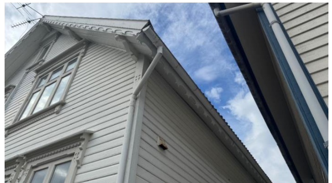
Det er ikke registrert råte i flekkete partier.
