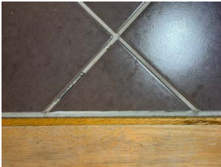
Løsnet fug i en flis ved dørterskel og bom i fliser utenfor dusjsone.
