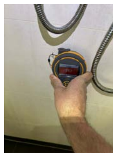
Fuktindikasjon under dusjbatteri
