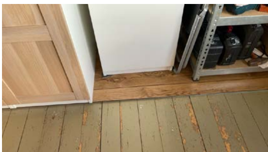
Opplyst om manglende gulvbord under klesskap.
