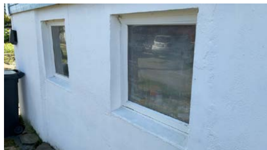
Mulig punktert vindu, kjeller
