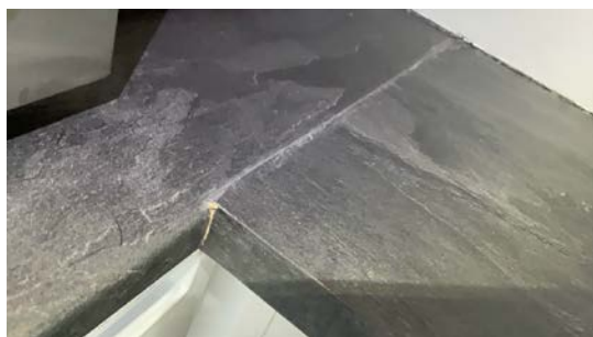
Svikt mellom benkeplater
