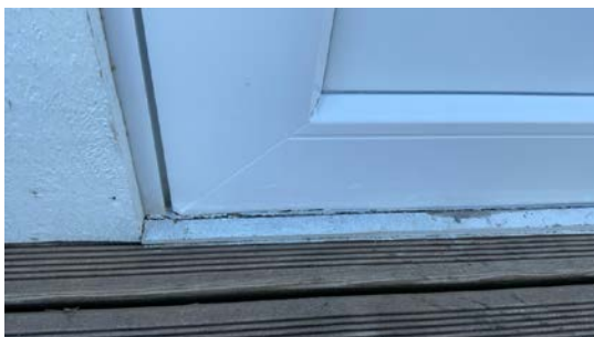
Manglende beslag under dør altan
