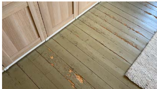
Stedvis overflateskader trebord
