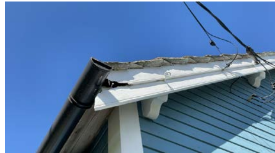
Parti med råte i vindske, ved inngang/trapp
