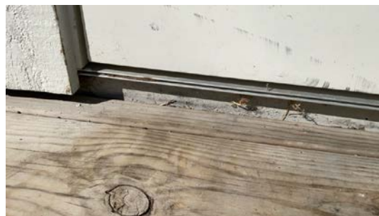
Manglende beslag under hoveddør
