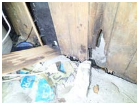
Råteskadet kledning mot grunnmuren.
