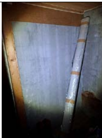
Vannmerker på murvegg. Kjeller
