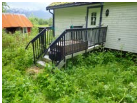
Rekkverk mangler på en side.
