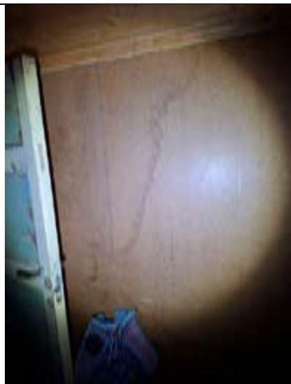
Fuktskjolder i huntonittplate. Kjeller
