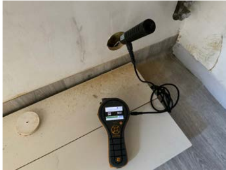
Hulltaking og fuktmåling
