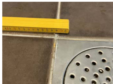
Noe kanting på fliser i dusjsone, fungerer som dette.
