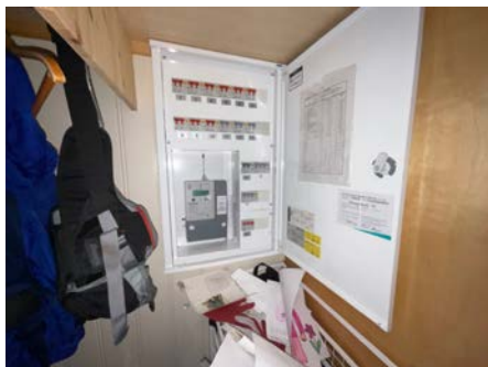
Sikringsskap plassert i hall bak skyvedørgarderobe.
