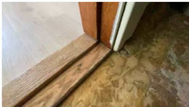
Sprekker i tettsjikt.
