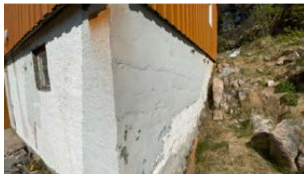
Tegn på utbedringer av ukjent årsak.
