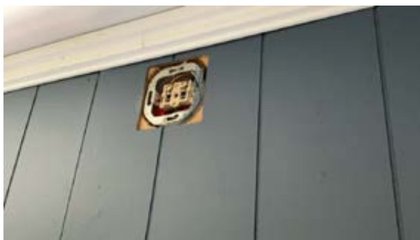
Manglende deksel over stikk medfører berøringsfare.
