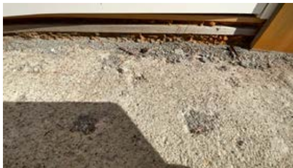
Manglende beslag ved balkongdør kjeller.
