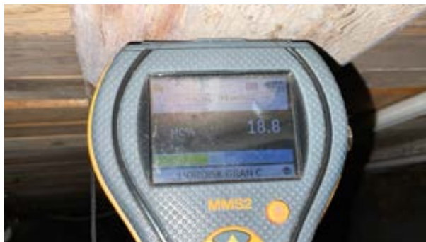
Det ble målt 18,8 vekt% fukt i etasjeskille ved dagens befarig.
