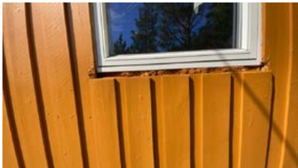
Manglende beslag på vindu mot øst.
