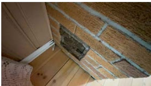
Sotluke i kjeller.
