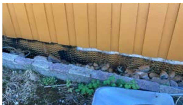
Manglende toppliste på grunnmur.
