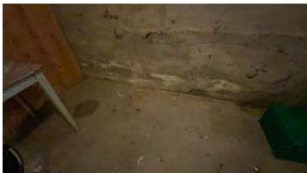
Visuelle tegn på fuktvandring i vegg/gulv mot tilstøtende terreng i boder.
