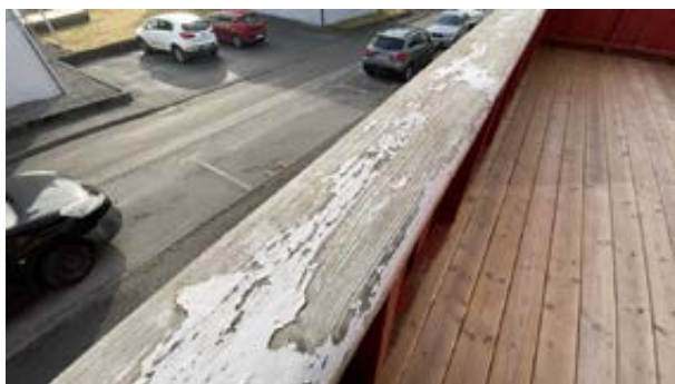
Slitt overflate på balkongrekke.
