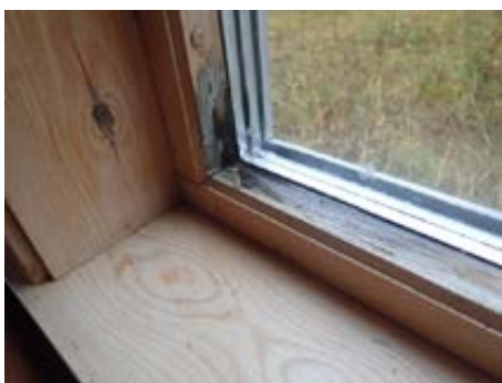
Råteskader i vindu.
