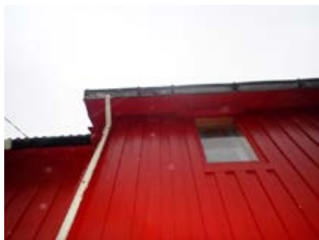
Lekkasje/hull fra takrenne
