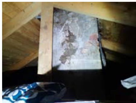
Lekkasje i pipen på kvisten
