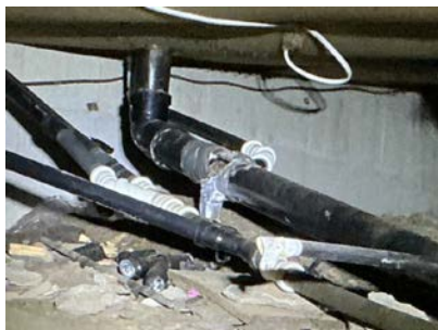
Avløps-rør er tapet over i skjøt.
