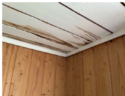
Synlige fuktmerker i tak. Ved fukt-søk er det ikke registrert unormale verdier.
