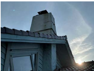
Sprekker på puss på pipe overtak. Beslag mellom pipe og vegg kan ikke forventes å være tett.
