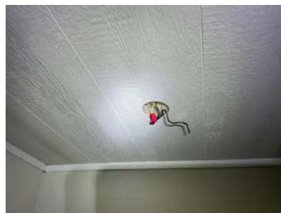
Deksel på takboks er ikke montert.
