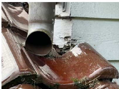
Fukt-råte på vegg mellom bolig og garasje.
