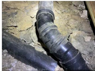
Avløps-rør er tapet over i skjøt.
