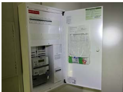
Sikringsskap står i gang 1 etasje.
