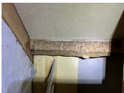
Fukt-skjolder på tak-gjennomføring til pipe.
