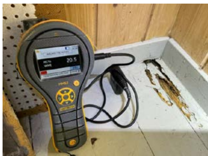
Synlig råteskade på gulv ved inngangsdør. Ved fukt-søk er det registrert forhøyede målinger.
