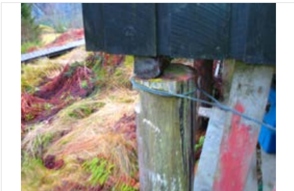
Stubbgulv og isolasjon har falle ned,
