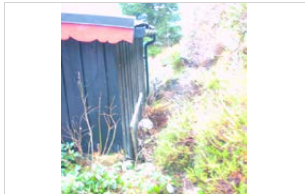
Vegetasjon helt inn til bordkledning
