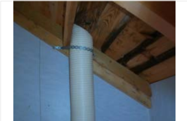
Taktro er fuktige på underside, trolig som følge av lekkasje i gjennomføring av kanal.
