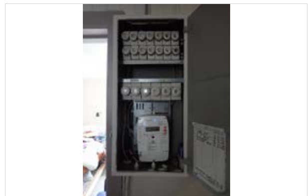
El-skap med krussikringer
