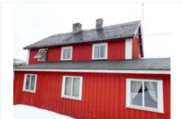
Skifertak og Pappshingel på tilbygg. 1/2 beslag på pipene + nedfall av stein.
