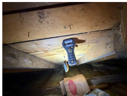
Fuktmåling i undertak i delen fra byggeår.
