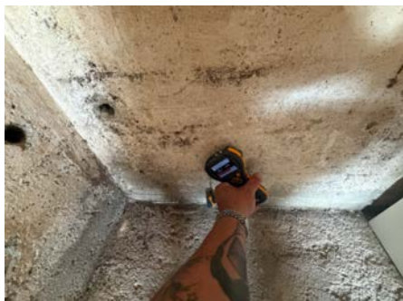
Fuktsøk, utslag på fukt.
