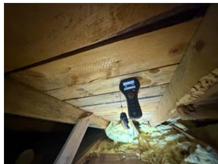
Fuktmåling i undertaket i tilbygg.
