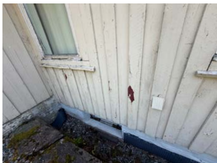
Dårlig kledning mot nord.
