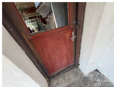
Karm er helt løs. Døren må skiftes ut.
