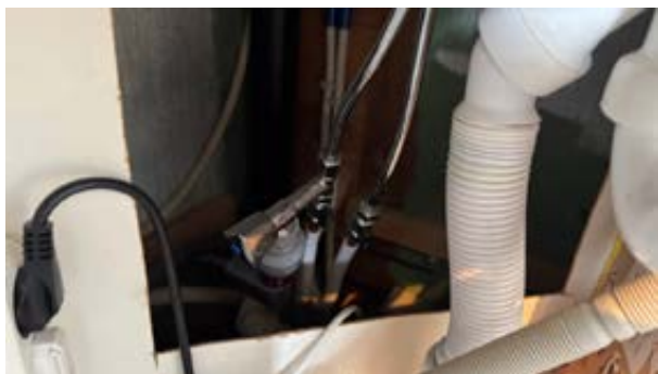
Vannledninger i bakkant av vaskseksjon er løse.
