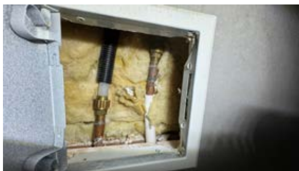
I luke under vask/bad 1.etg. er det vannledninger fra 1980 tallet og nye rør i rørsystem. Sort slange utenpå vannledning (varerør) mangler mansjett/tettermuffe.
