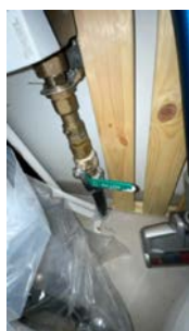
Hovedstoppekran i vaskerom/teknisk rom.
