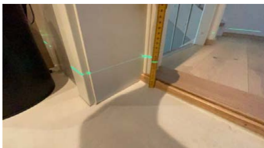
Høydeforskjell (flis ved terskel)
