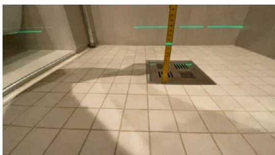
Høydeforskjell (ved sluk)
