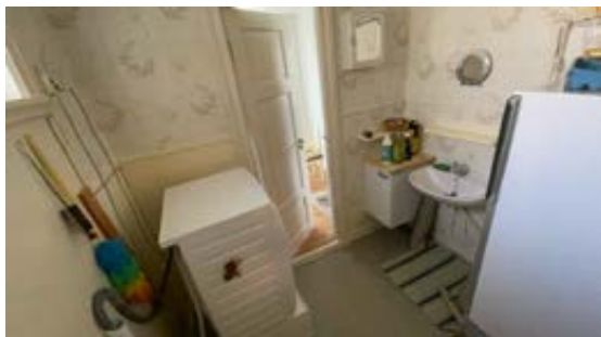
Vaskerom i 1. Etasje.
