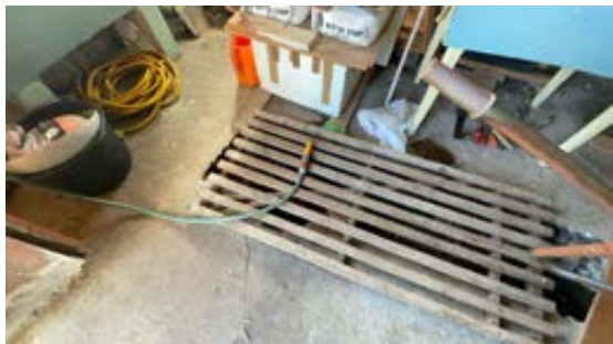
Manglede gjennstøping rundt avløpsrør i kjeller.
