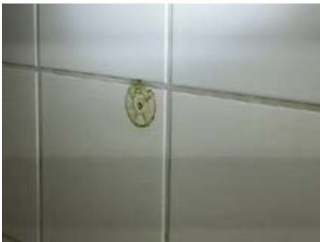
Det er boret hull i vegg bak dusjkabinett.
