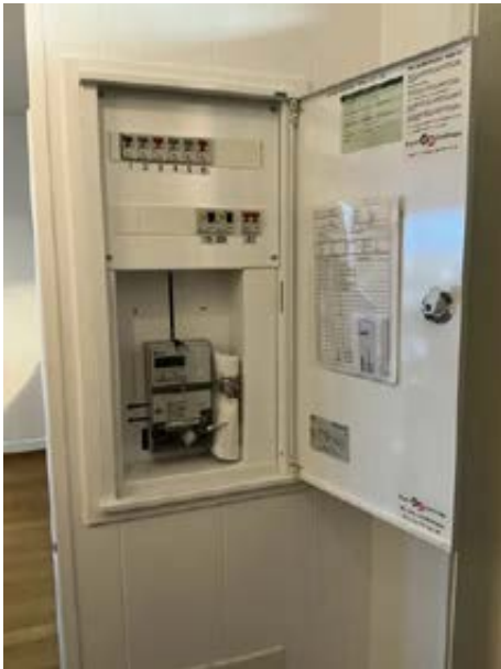
Sikringsskap står i entre/gang.
