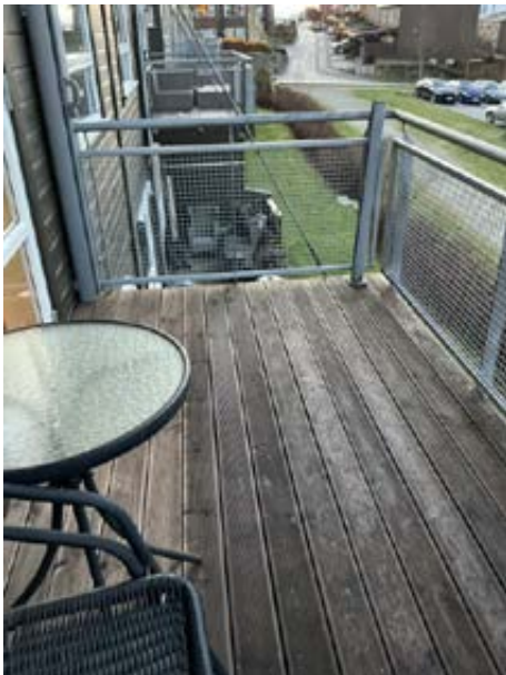
Terrassebord fremstår med normal slitasje.
