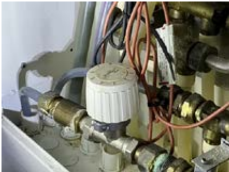
Ventil til regulering av gulvvarme i bad.
