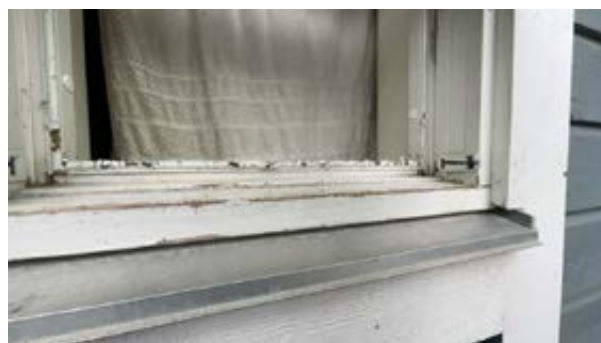
Det er skade på pakning og flere vinduer er værslitte.
