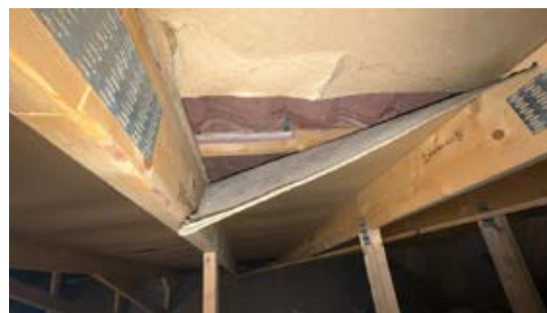
Skade i underetaket.
