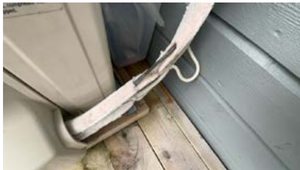
Skade på isoalsjon.
