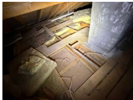
Eksempel på manglende isolasjon i loftbjelkelaget.
