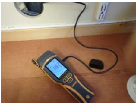
Kontrollmålt 18.5 fukt i konstruksjonen
