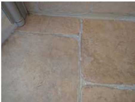
Riss i flisfuger i dusj
