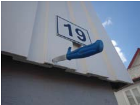
Råteskade i ende kant mot nord.
