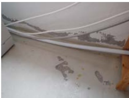
Saltutslag innvendig i vaskerom
