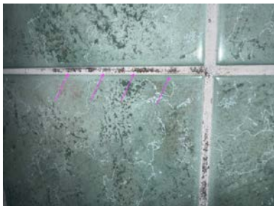
Det er svertesopp og riss i fuger.
