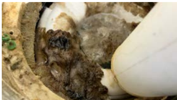
Sluk på bad under kabinett
