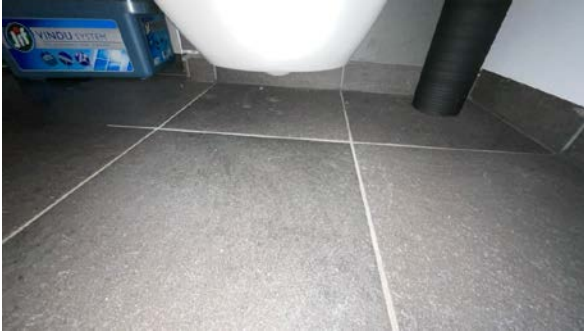
Lekkasjespalte på innebygget sistene bør opparbeides.
