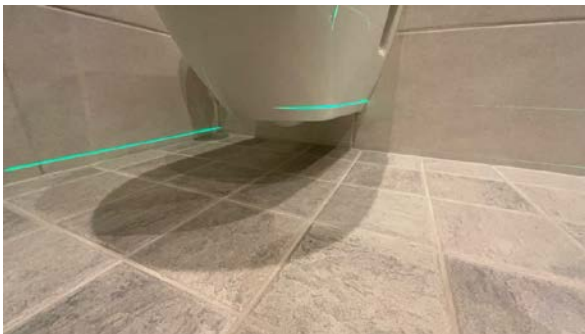
Lekkasjespalte på innebygget systerne bør opparbeides.
