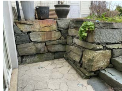
Rekkverk på støtter-mur er ikke etablert.
