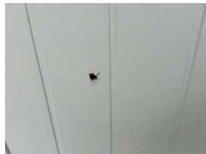
Skade på terrasse-dør 2 etasje.
