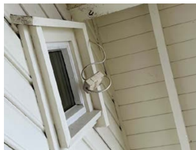
Løs ledning synlig fra balkong 2 etasje
