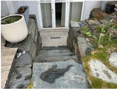
Rekkverk/hånd-rekke på trapp til kjeller er ikke montert.
