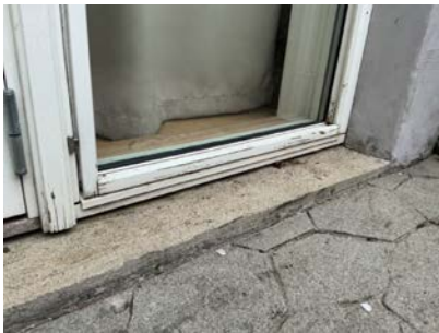
Beslag på nedre del av vindu er ikke etablert.
