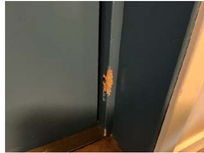
Skade på karm inngangsdør.
