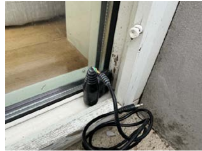
Fukt/råteskade på utvendig list mot glass TG 3.
