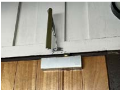
Dør-pumpe til inngangsdør er defekt.
