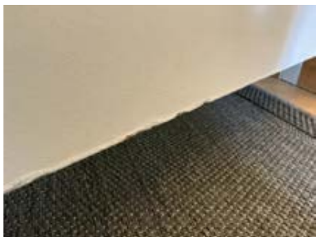
Noe svelling på dør.
