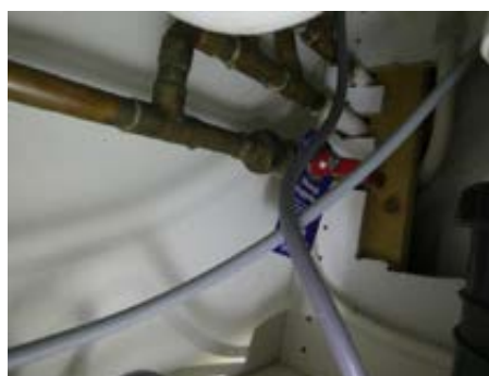
Kopper vannrør og stoppekran i kjøkkenskap
