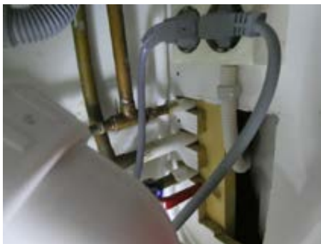
VVB innebygget i kjøkkeninnredning
