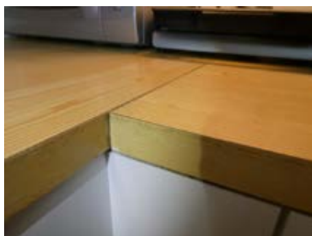
Liten avvik i skjøte på benkeplate
