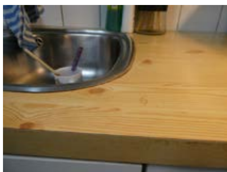
Svertesopp mellom benkeplate og beslag
