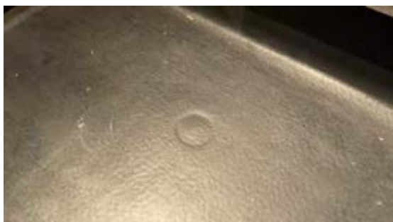
Merke i våtromsbelegget.
