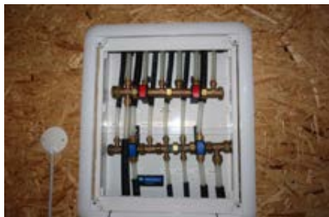
Fordelerskap med rør i rør opplegg.
