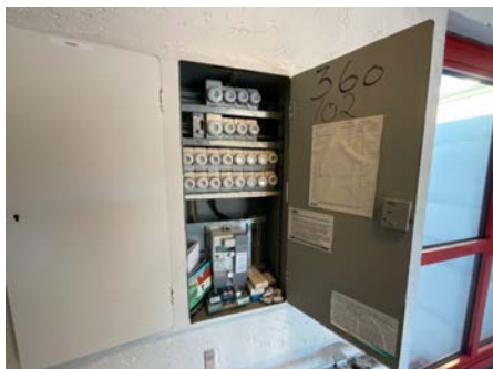
Sikringsskap plassert i felles trappegang
