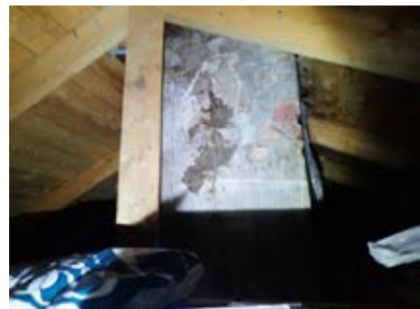
Lekkasje i pipen på kvisten
