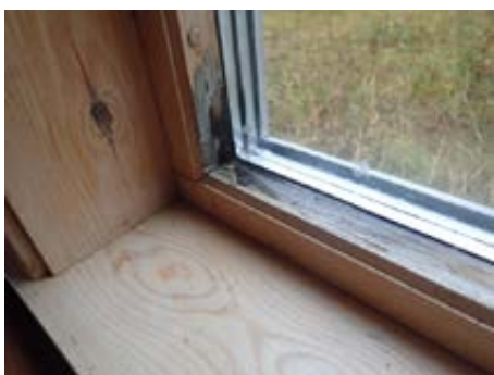
Råteskader i vindu.
