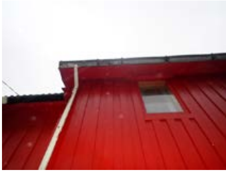
Lekkasje/hull fra takrenne
