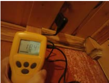
Målt 18% fukt i tak ved pipen på soverom. Synlige fuktmerker i panel og taklis
