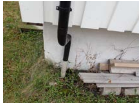
Avløp til drenering
