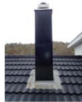
Heldekkende pipebeslag. Ikke stigetrinn og plattform
