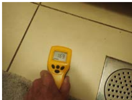
Ingen fuktindikering i gulv.
