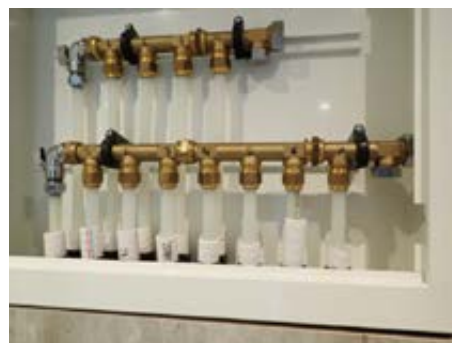
Rør i rør skap på bad på loft
