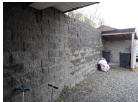
Støttemur mangler rekkverk
