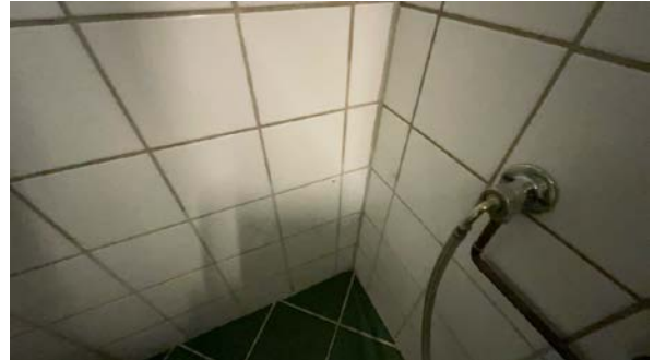
Synlige skruer hull på vegger.
