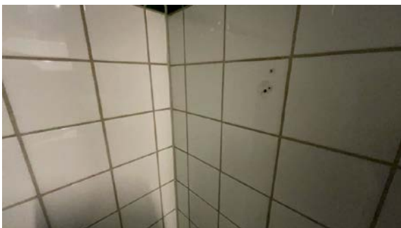
Synlige skruer hull på vegger.
