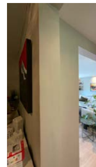
Stedvis synlige avvik på vegger. Lokale utbedringer er påregnelig.
